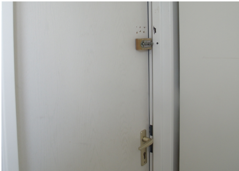
Duschtür mit Riegel außen!
