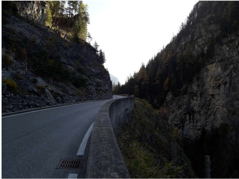
Neben der Straße eine Schlucht
